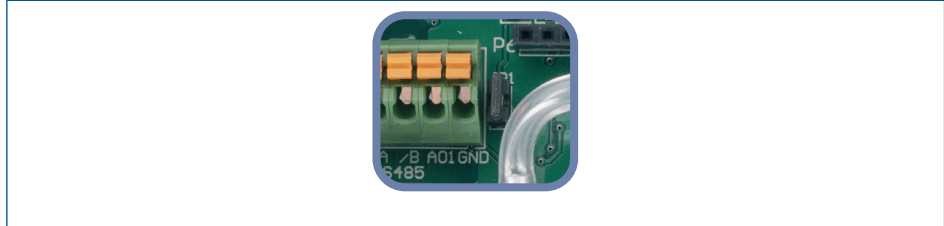
Рис. 5 Соединительная перемычка резистора подключена
