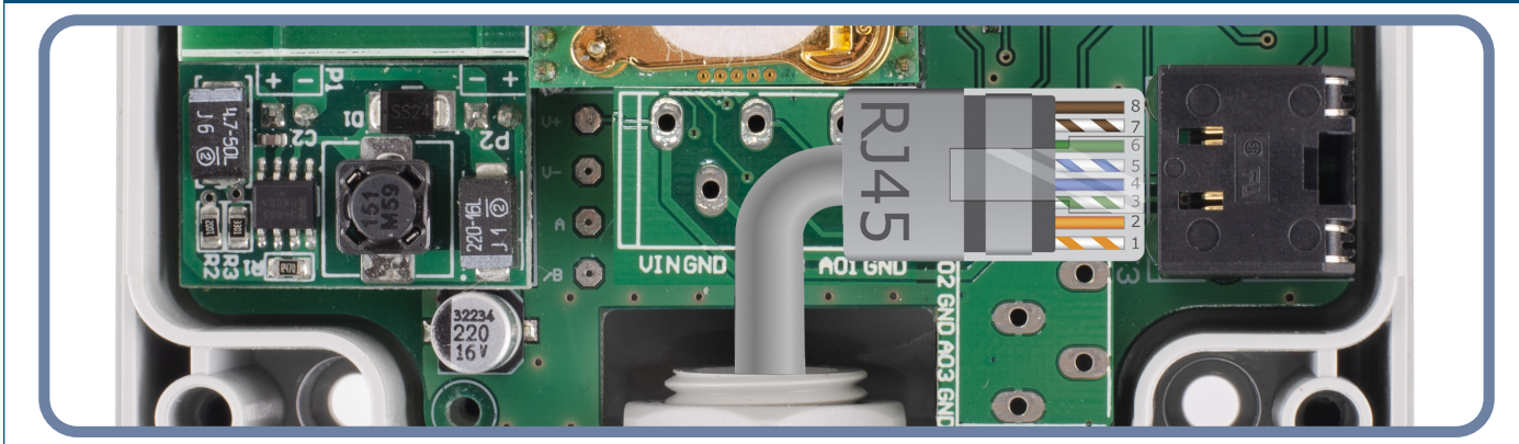
Fig. 4 Verkabelung und Anschlüsse
